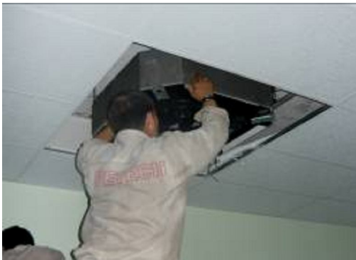
UCASS-X7G có công nghệ module nên dễ dàng thi công lắp đặt cho mọi loại phòng mổ, không yêu cầu phải ngưng hoạt động.
